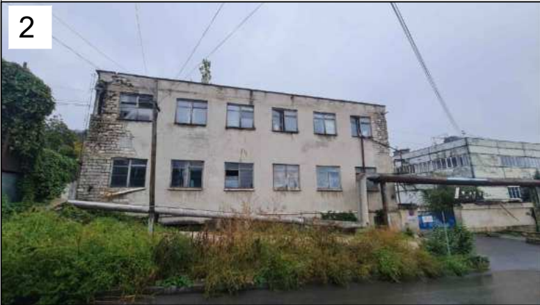
TEREN Cladire in stare avariata poate provoca accident rutier si prezinta pericol pentru viata
